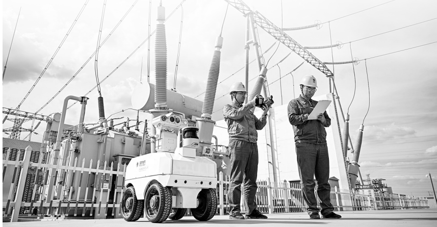
6月27日,国网银川供电公司变电运维中心员工在甘露330千伏变电站开展“人机联合”巡检。
